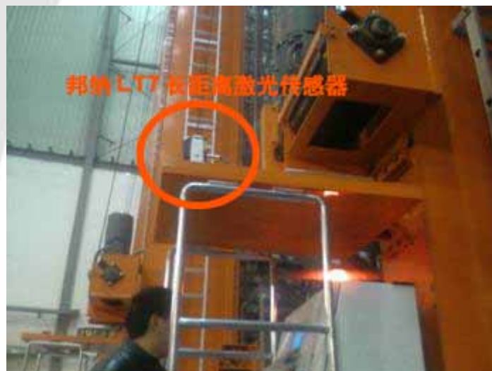
巷道堆垛机中激光测距及定位
